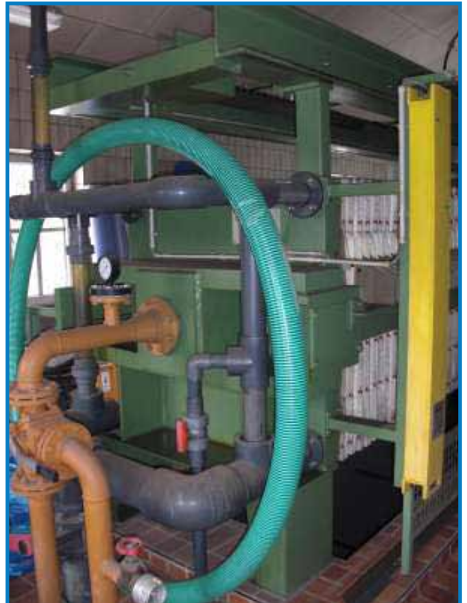
KFP 1200 Zulauf, Lichtschranke
